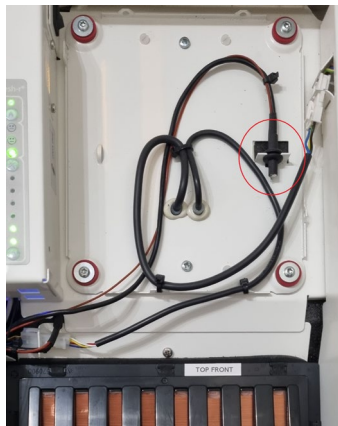
Figuur 5 Bovenste fan met sensor aan de rechterkant (rood omcirkeld)
