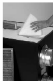
Afb.6.3 inbrengen nieuw filter.
